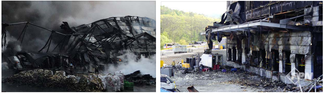
[그림 2] 화재발생에 따른 건물 외벽 변화
