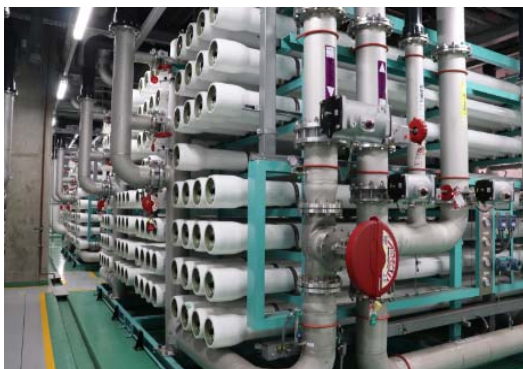
[그림 3] RO(Reverse Osmosis)시설
